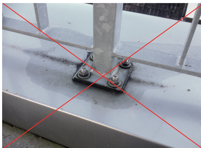
Abb. 7: Mangelhafte, unzulässige Ausführung
