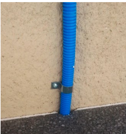
In der Wärmedämmung
